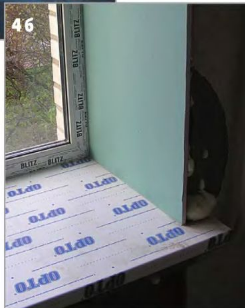
Затем точно так же подгоняют по длине и устанавливают правую и левую боковые панели.
