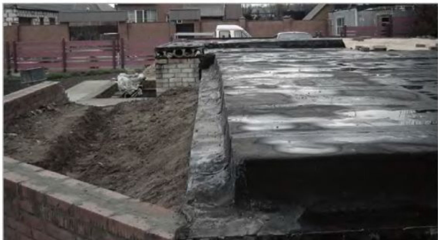
Фундамент, доставшийся «в наследство» новому хозяину участка от его прежнего владельца.
