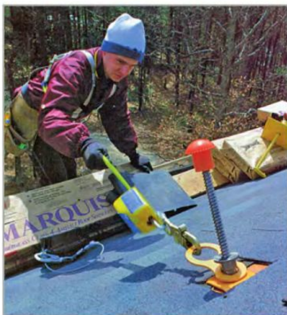
Смонтированное на крыше страховочное анкерное крепление, плотно прилегающая к туловищу привязь и надёжный страховочный строп позволяют кровельщику сосредоточиться исключительно на работе.
