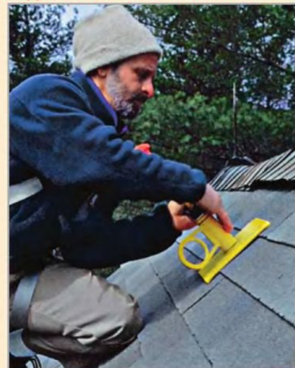
Г-образный конец анкера прикрепляют снизу к стропильной ноге с помощью металлической скобы.
